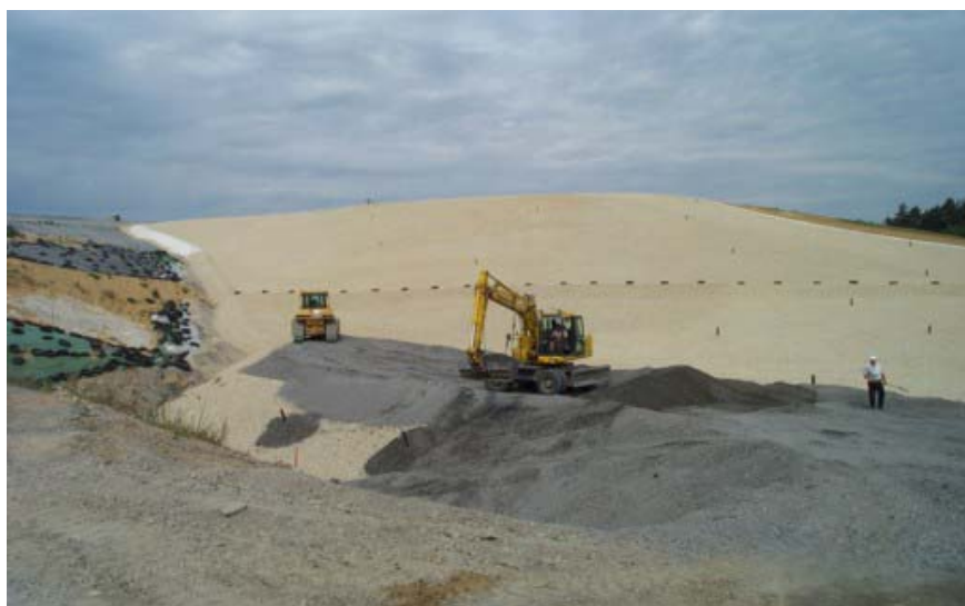
Abb. 5: MV-Asche als Ersatz für eine geotextile Trennlage (Vlies) auf dem Kiesflächenfilter (Dränage) einer Basisabdichtung
