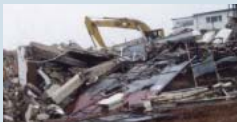
unkontrollierter Abbruch mit unzureichender Abfalltrennung
